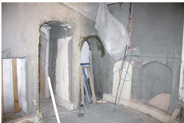
Фрагмент центрального алтаря до ремонта
